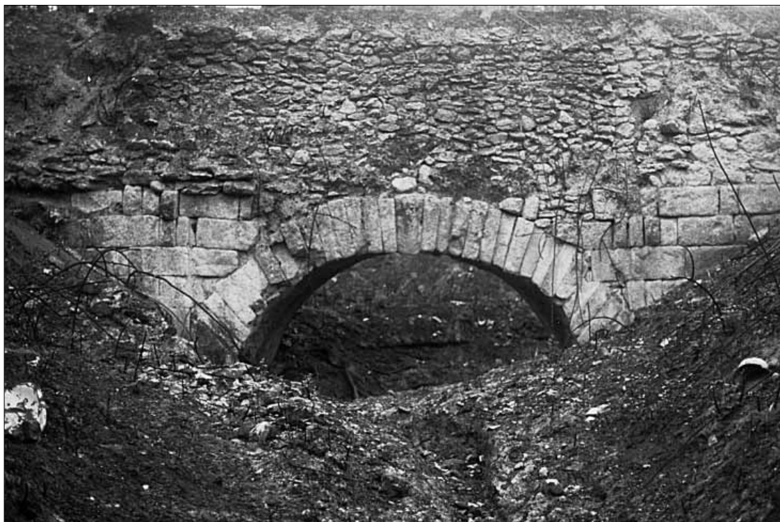
Lam. 1. Puente sobre el barranco de la Frontera. Vista después del incendio forestal de 1994
